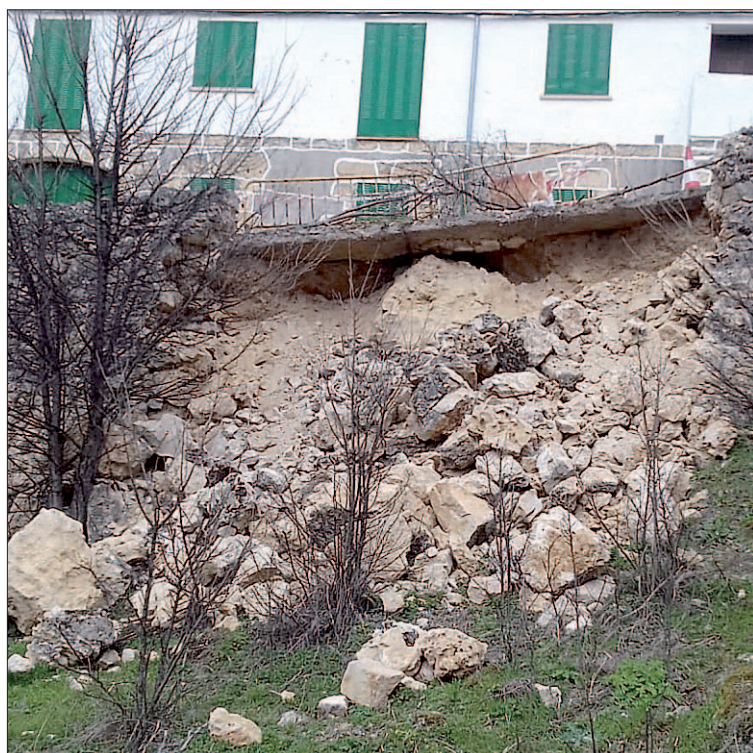
Imagen de los desprendimientos ocurridos en la calle Cansajal. / EL ADELANTADO
