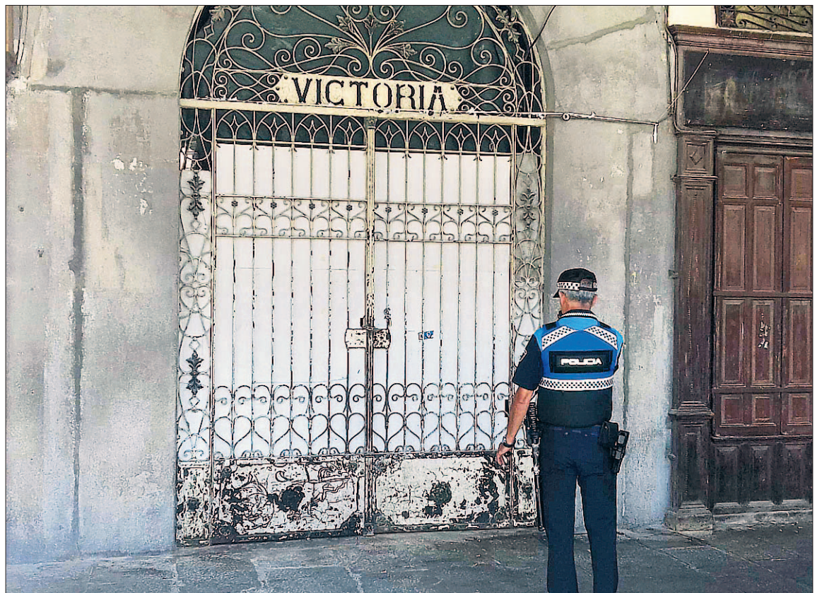
El antiguo hotel Victoria, cuya entrada está bajo los soportales de la Plaza Mayor, se encuentra en mal estado de conservación. / E. A.
