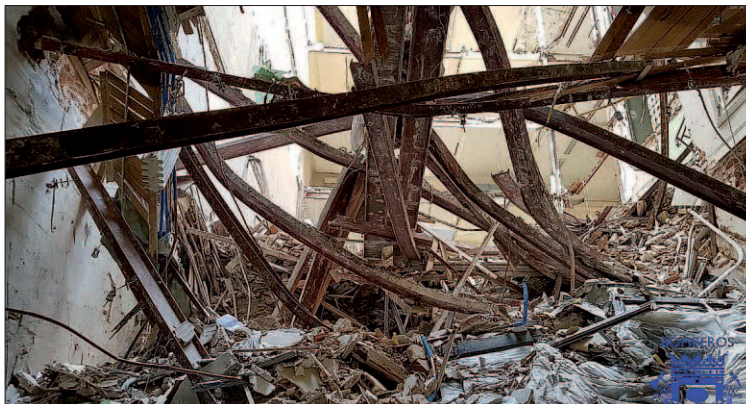
Los bomberos buscaban a los obreros desaparecidos tras el derrumbe. / EFE
