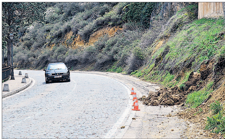
Desprendimiento de rocas en la Cuesta de los Hoyos a principios de año. / K.
