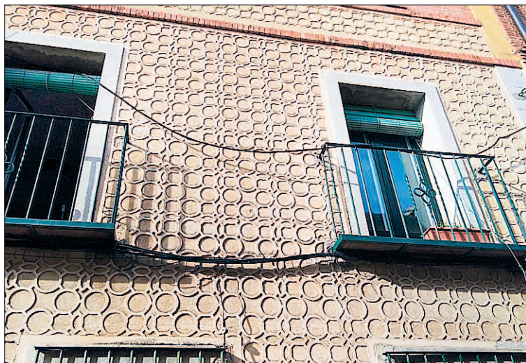
Cableado entre balcón y balcón en una vivienda de la calle Daoiz. / E. A.
