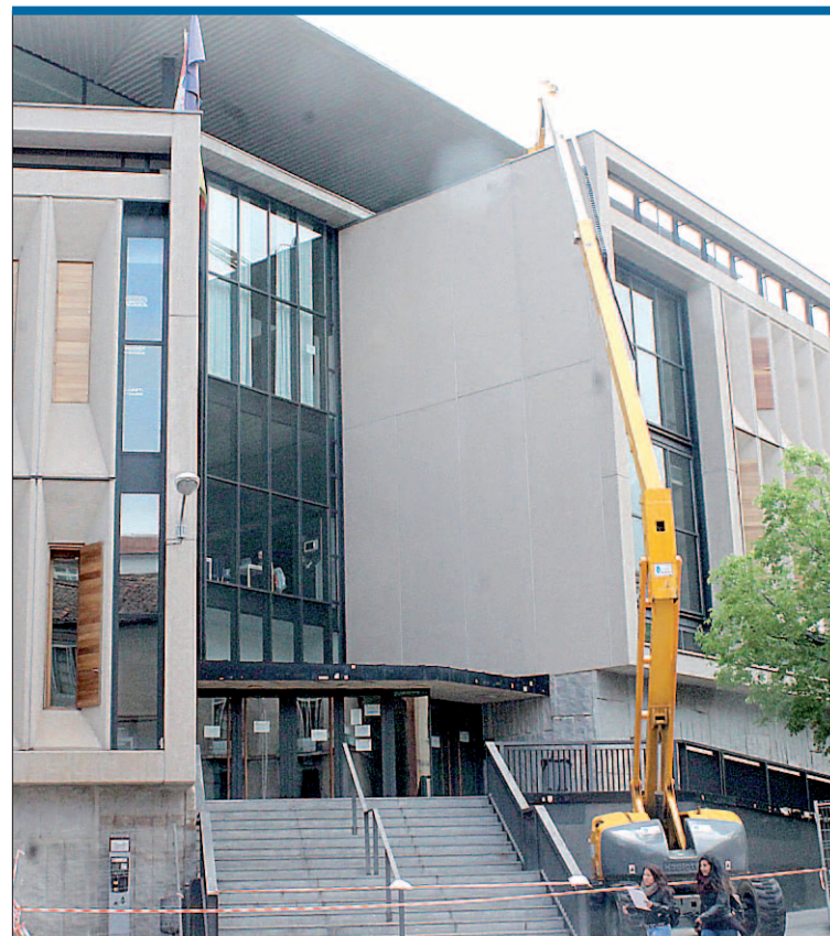
Los efectos de la nieve. La empresa constructora de la primera fase de las obras del campus María Zambrano está llevando a cabo los trabajos de reposición de las cornisas del edificio principal, dañadas por el efecto de la nevada de la fiesta de Reyes Magos. / FOTO: M. G.
