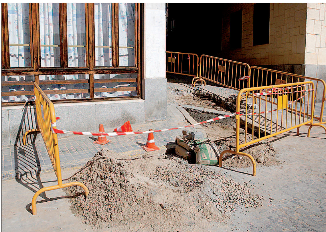
En la calle Alfareros se ha reparado ya la avería en la red de abastecimiento y solo falta cerrar socavón. / NEREA LLORENTE
