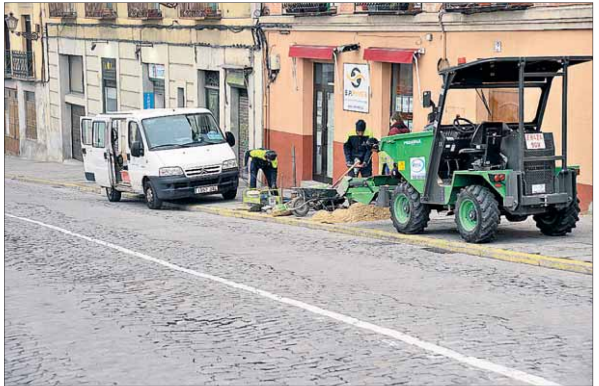
En noviembre pasado se ejecutaron unas obras en esta acera de San Juan, donde las baldosas estaban hundidas. / KAMARERO
