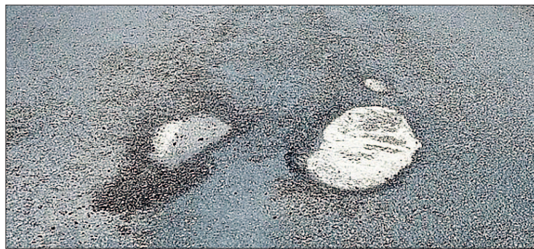
Detalle de los problemas detectados en el asfalto. / EL ADELANTADO
