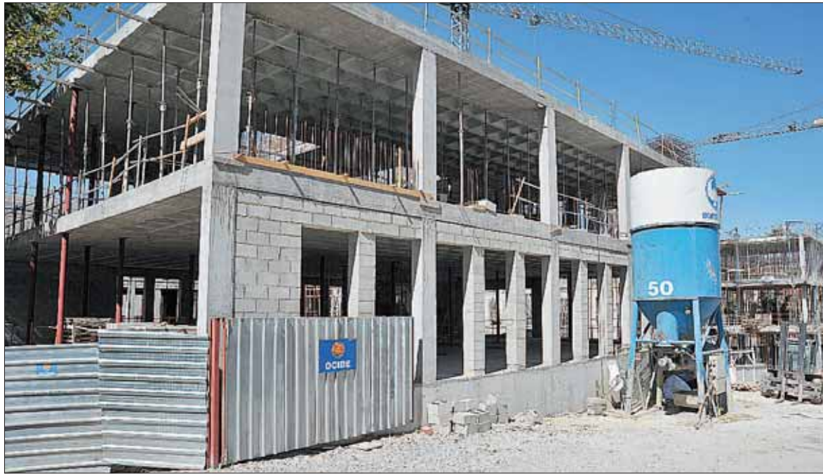
La segunda fase del campus de la Uva, ejecución, se llevará 3,1 millones de los Presupuestos de 2018. / KAMARERO
