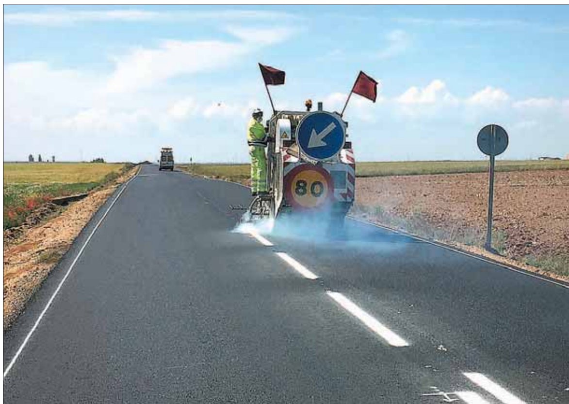
Una de las máquinas, en pleno proceso de pintado de las marcas viarias. / EL ADELANTADO
