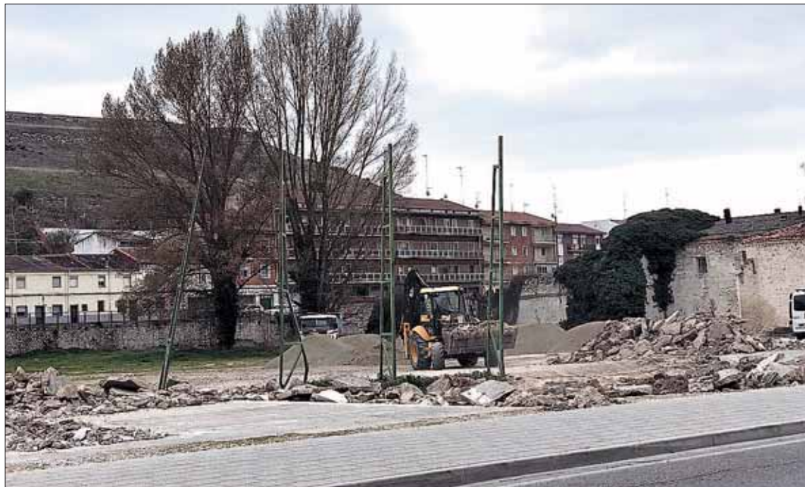
Máquinas comenzando a trabajar en la zona de 'El Soto, donde se ubicará el aparcamiento de autobuses./ C.N.
