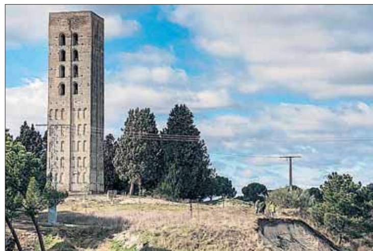
Imagen del estado actual de la torre de San Nicolás en Coca. / KAMARERO
