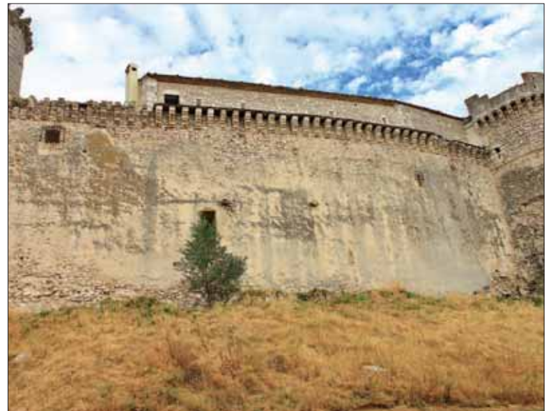
Aún se aprecia el primitivo enfoscado de esta fachada oeste. / JUAN CARLOS LLORENTE
