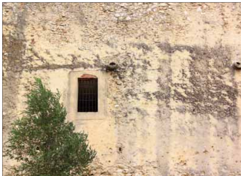
Ventanal abierto durante la ocupación penitenciaria y los dos canales de desagüe de las antiguas cocinas. / JUAN CARLOS LLORENTE
