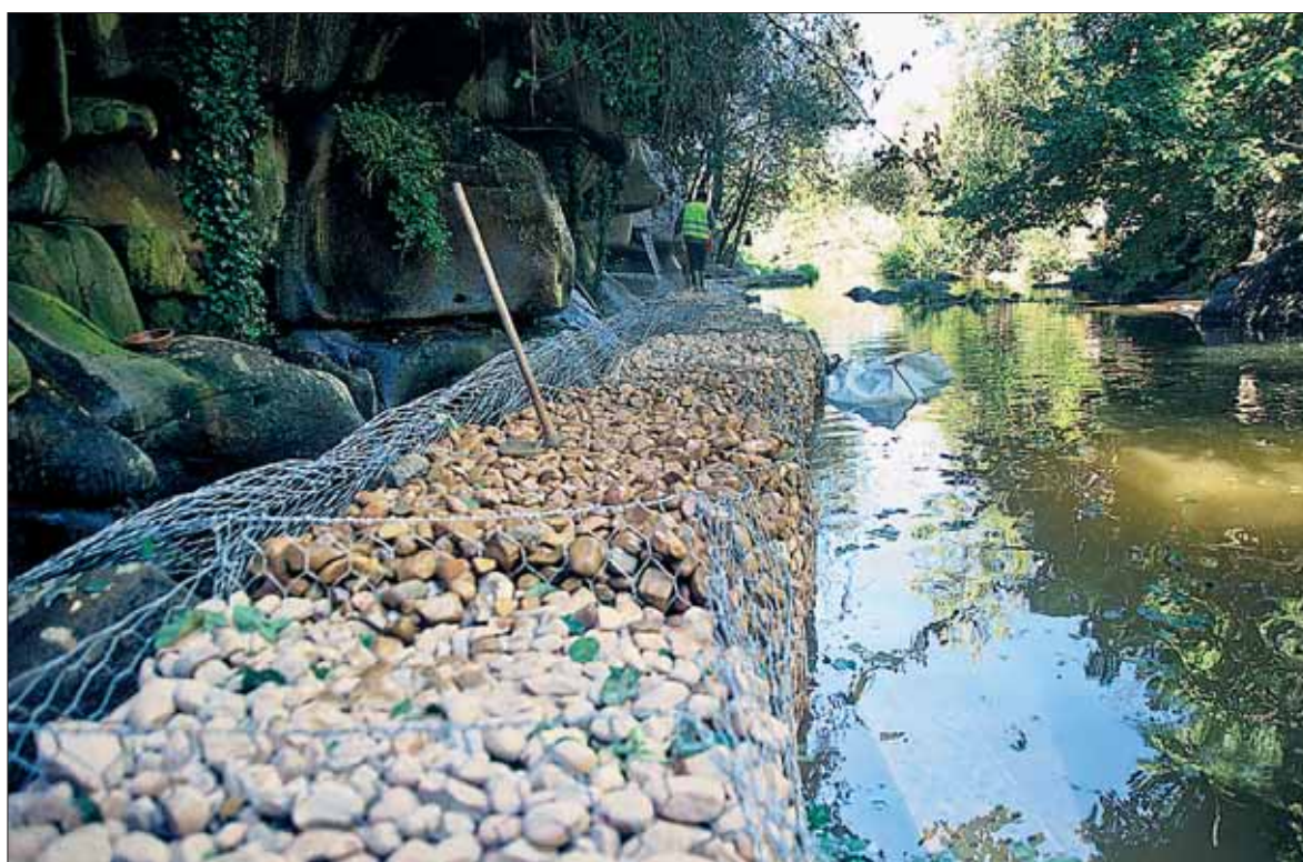
Trabajos de colocación de los gaviones en un tramo de la senda junto a la rivera. / KAMARERO
