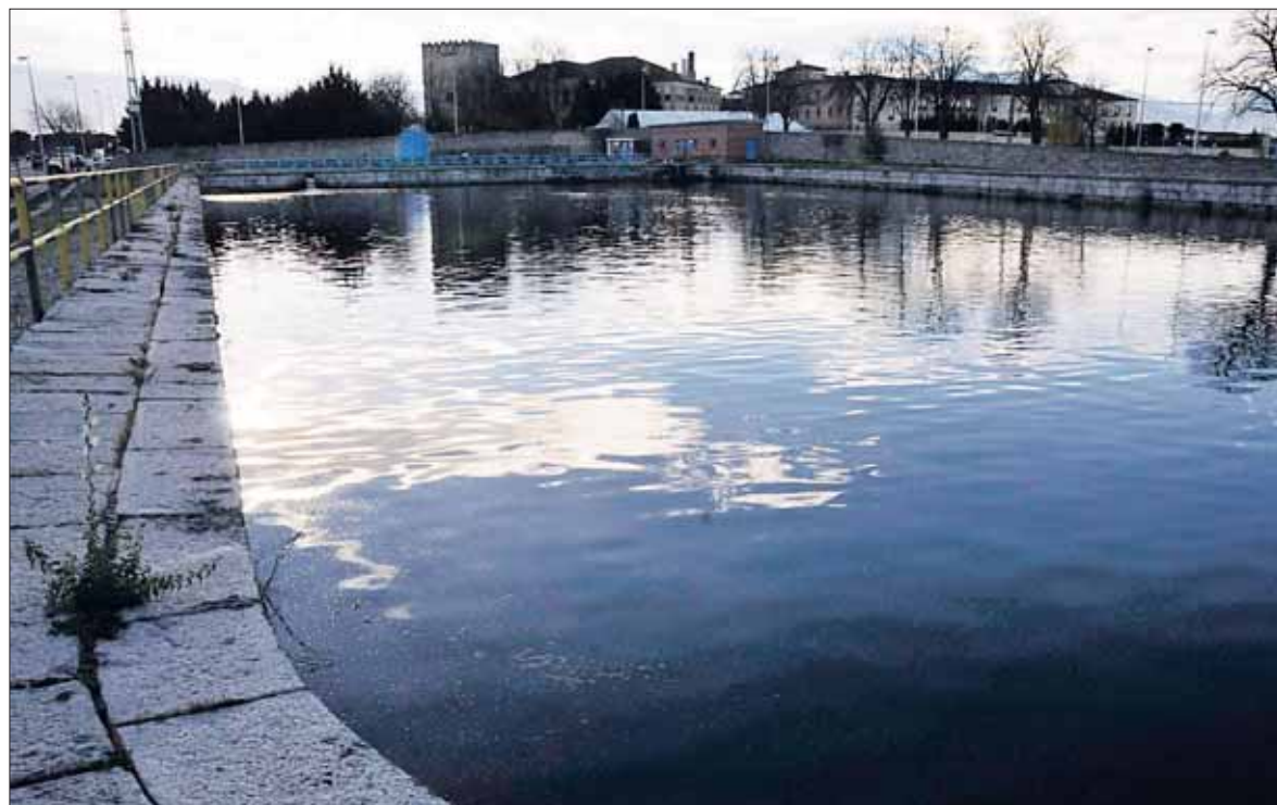
ETAP de los Depósitos de Agua, situada en la carretera de La Granja de la capital segoviana. / JUAN MARTÍN
