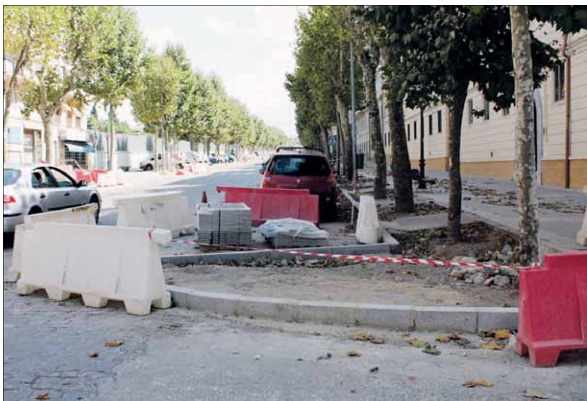
Estado de ejecución de la primera fase de las obras de la avenida de la Constitución. / M. G.
