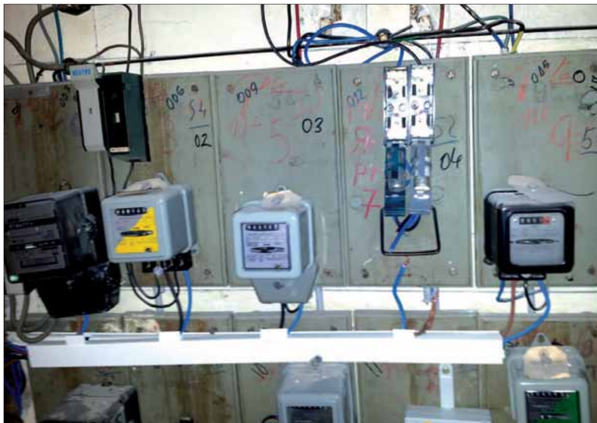
Algunas de las viviendas contaban con suelo radiante para la calefacción, por lo que el suministro de luz era muy elevado. / E.P.
