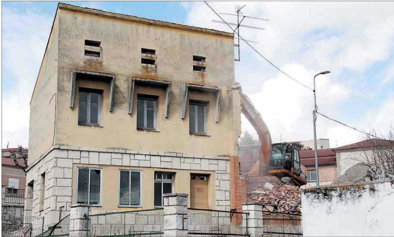
Momento en el que una máquina excavadora procede al derribo del viejo inmueble donde se encontraba la antigua casa del conserje y algunas aulas. /CARLOS PASCUAL
