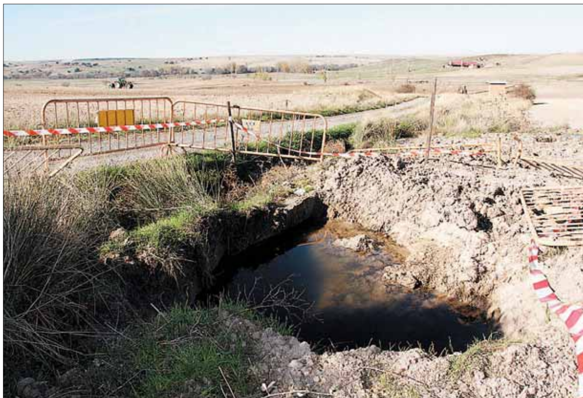
Los vecinos indican que este charco de agua se debe a una fuga de las conducciones de abastecimiento. / F. DESCALZO
