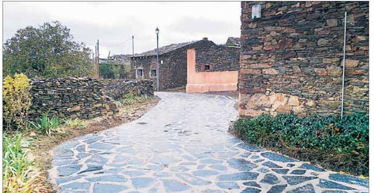
Estado en que ha quedado la calle Iglesia del pequeño pueblo de Serracín. / EL ADELANTADO
