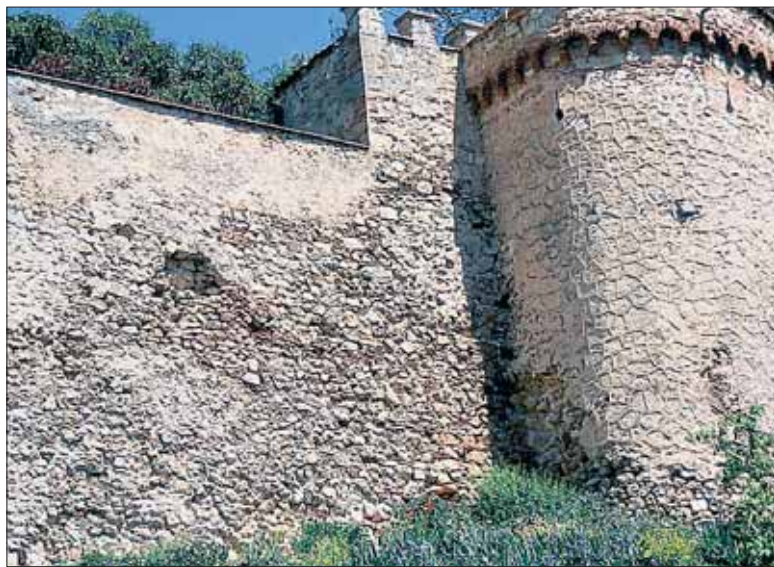
Imagen de la zona afectada por los desprendimientos. / EL ADELANTADO
