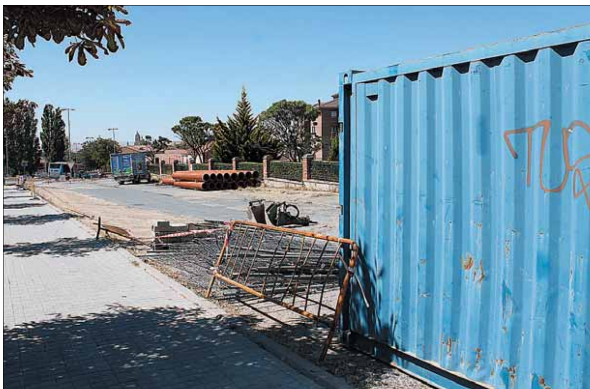
La caseta de obras fue instalada el lunes y ayer ya se habían iniciado los primeros trabajos junto a la carretera de Palazuelos. /M.G.
