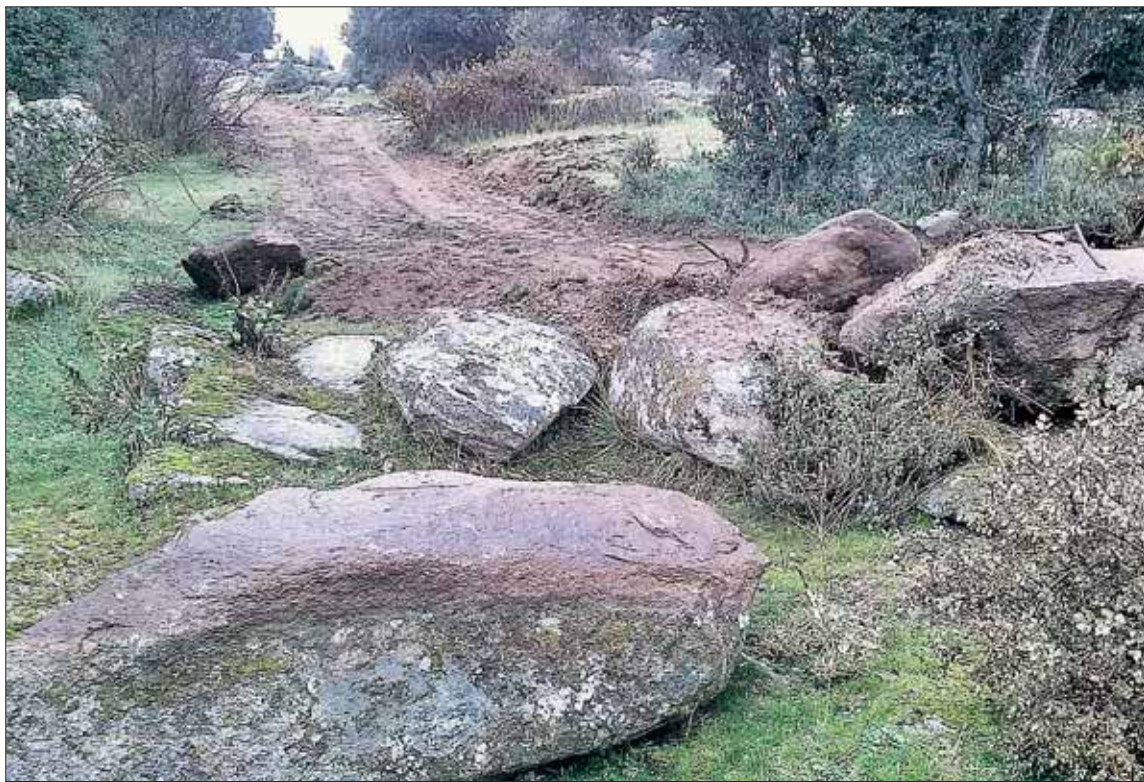
Obras en la cañada real Soriana Occidental, en una imagen de archivo. / EL ADELANTADO
