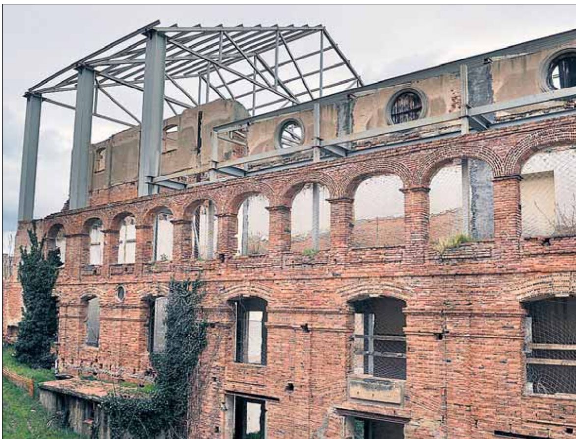
Las cerchas están situadas en la cubierta de la caja escénica del teatro. / KAMARERO
