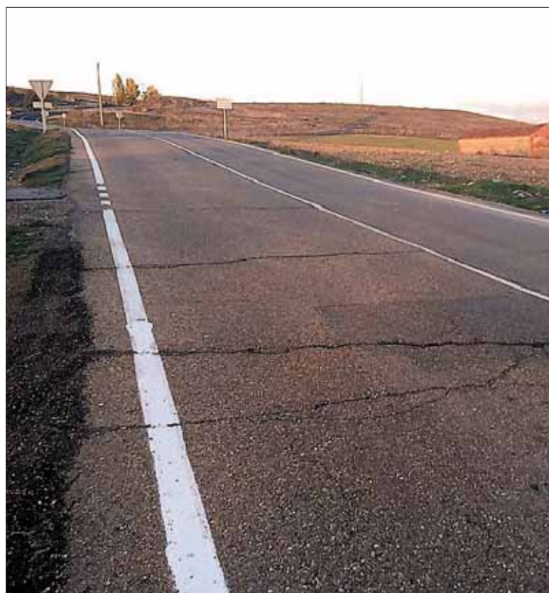
La carretera presenta grietas a pesar de las recientes obras. / EL ADELANTADO
