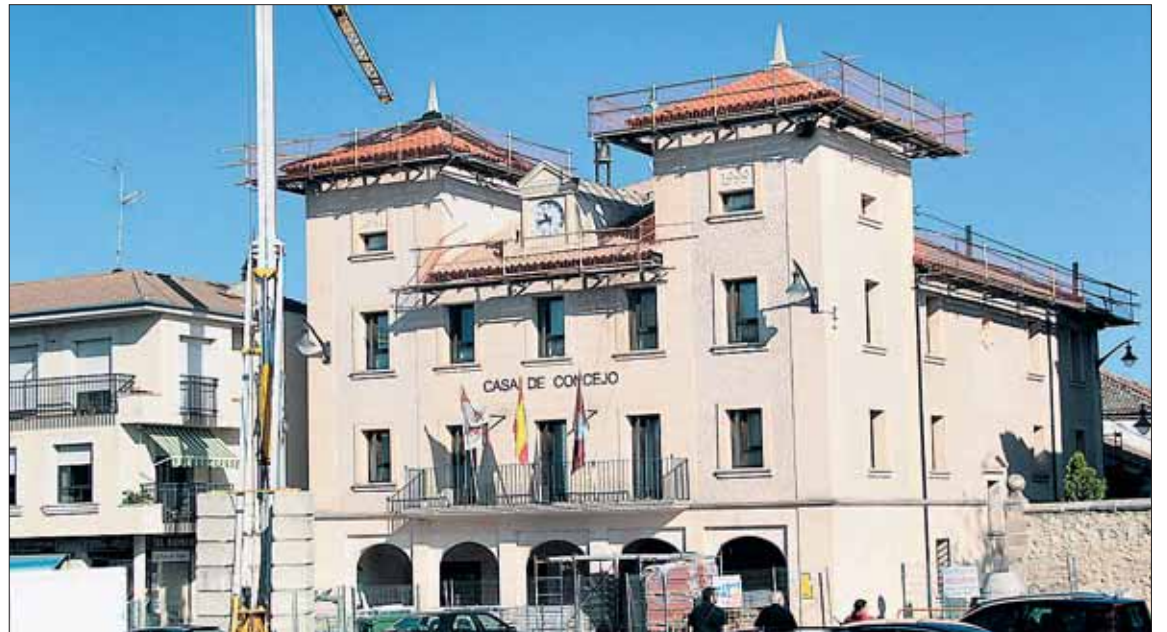
Los trabajos han requerido la instalación de una grúa y andamiaje que ha afectado al mercado de los viernes. / F. D.
