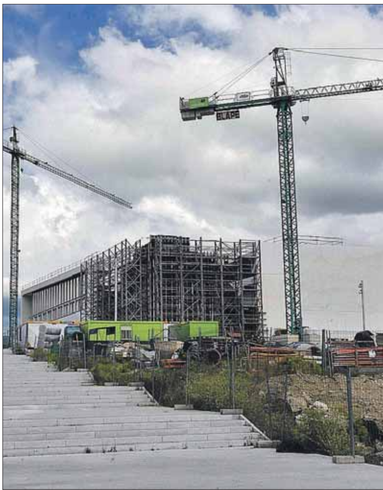
Las obras del primer edificio del CAT fueron paralizadas a principios de verano tras la liquidación de Volconsa, adjudicataria de las obras. / KAMARERO
