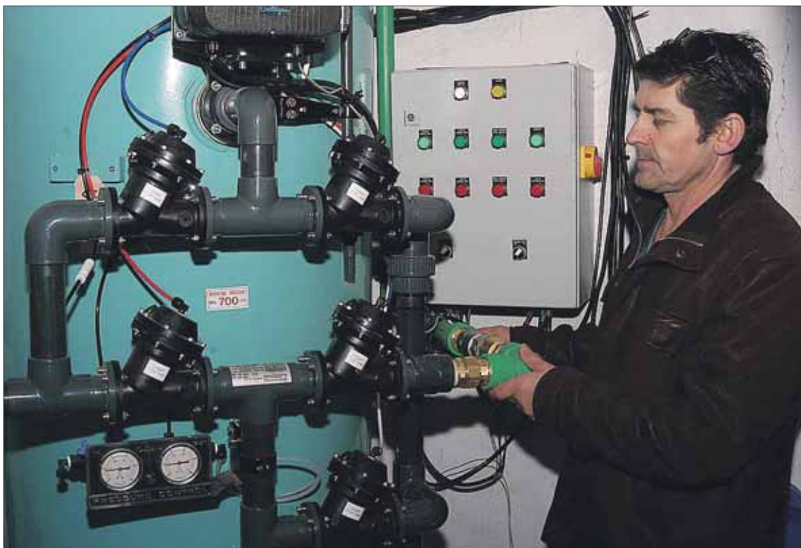
Filtro instalado en Fuentepiñel, que permitió que el pueblo volviera a tener agua apta para el consumo. / GUILLERMO HERRERO
