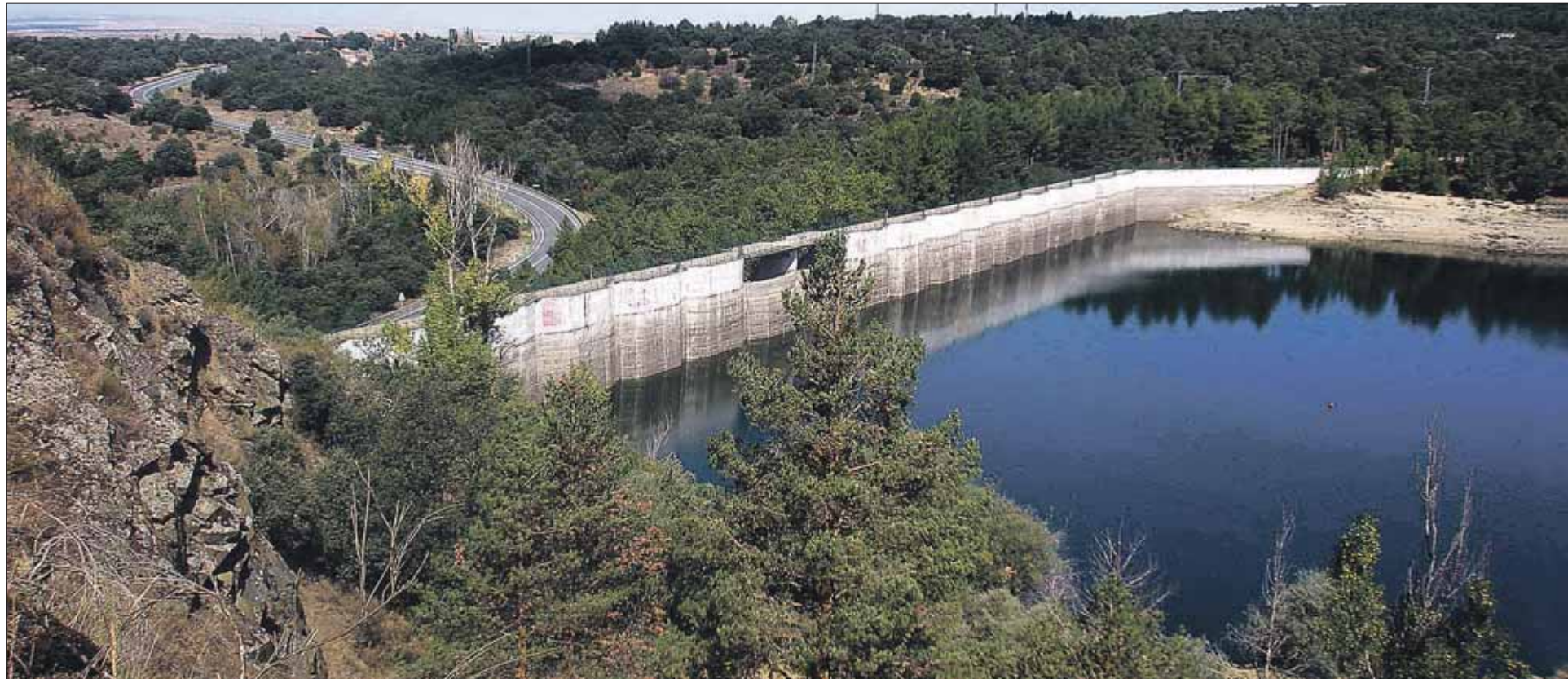
La presa de Puente Alta, en Revenga, fue construida en 1953 y embalsa 2,5 Hm 3 . El proyecto pretende ampliar la capacidad del embalse, propiedad del Ayuntamiento de Segovia. / JUAN MARTÍN
