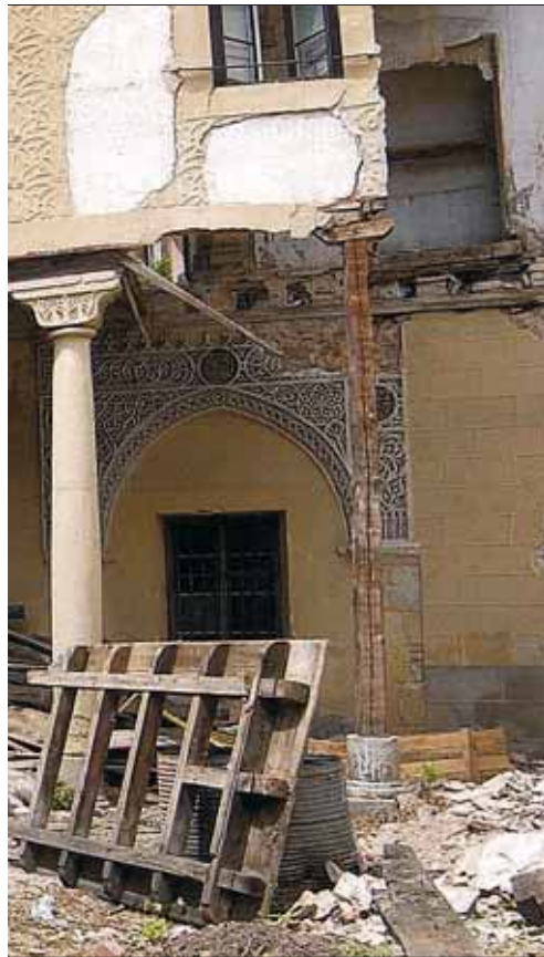
encia para evitar la ruina del inmueble. / J.MARTÍN
