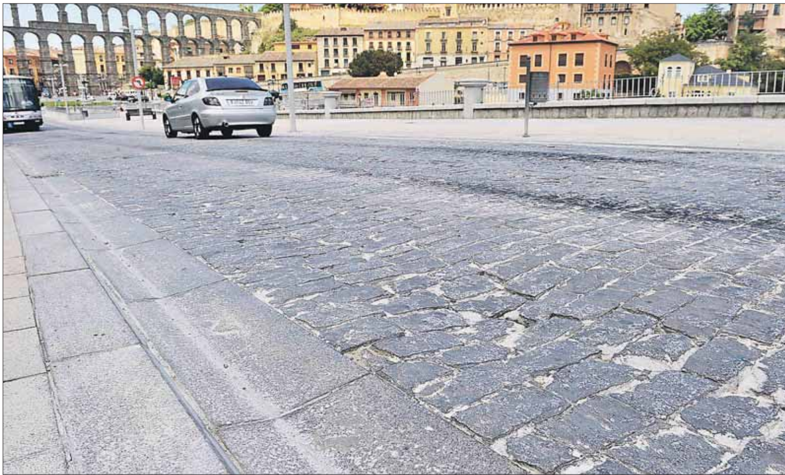
Imagen del estado de la calzada antes de su reparación. El firme presentaba numerosos hundimientos. / KAMARERO
