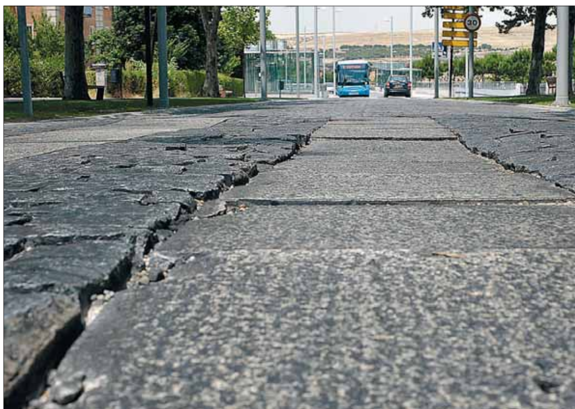
El estado del firme en este tramo de la calle presenta un deplorable aspecto. / JUAN MARTÍN
