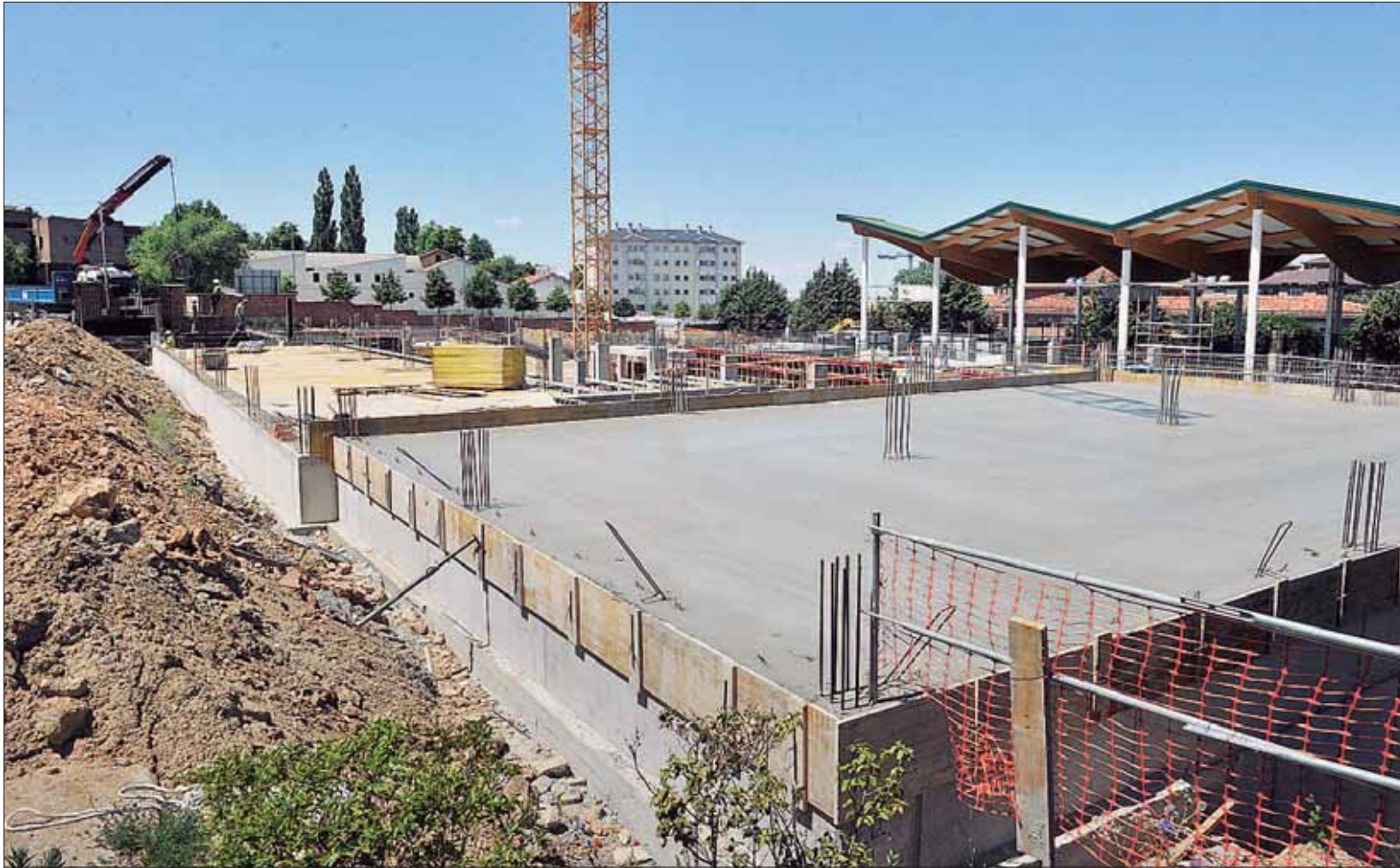
Estado de las obras de la segunda fase de construcción del complejo deportivo Carlos Melero, en la ciudad deportiva de La Albuera. / KAMARERO
