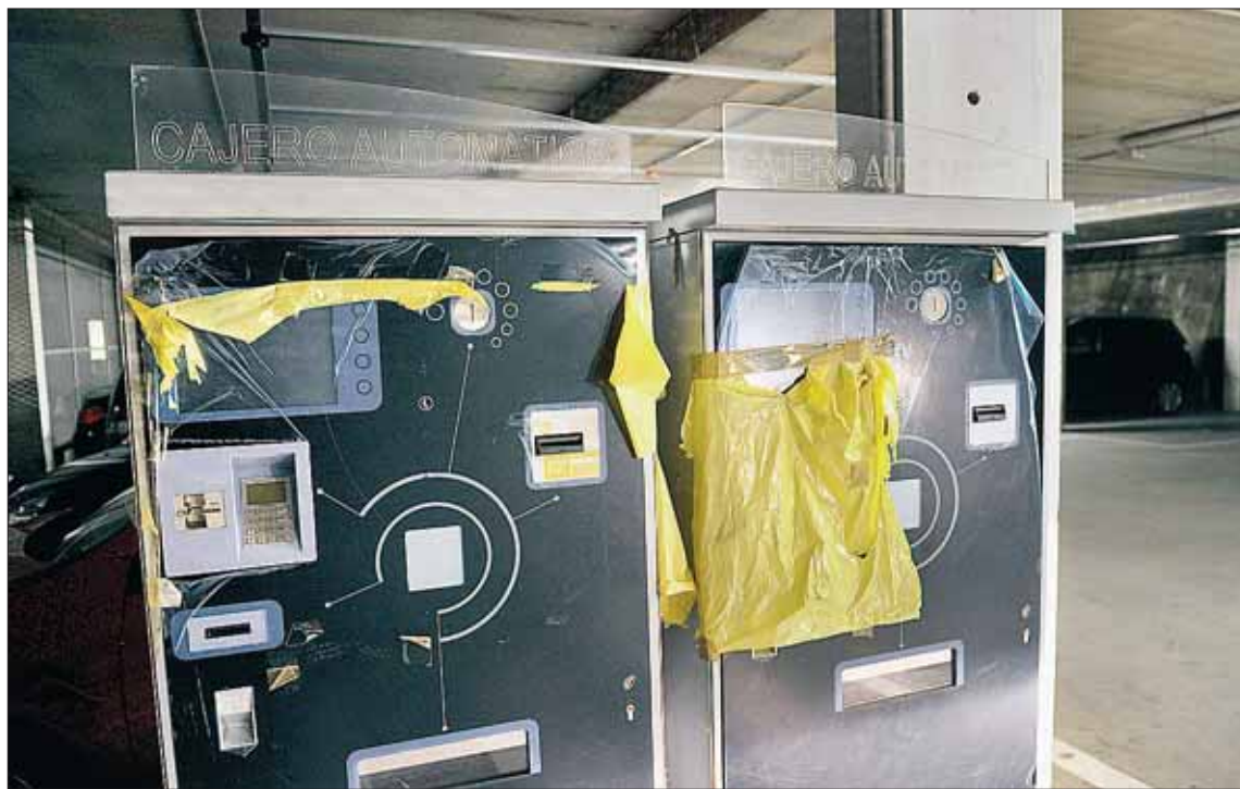
Los parkímetros, ya instalados, llevan inoperativos más de dos años. / KAMARERO
