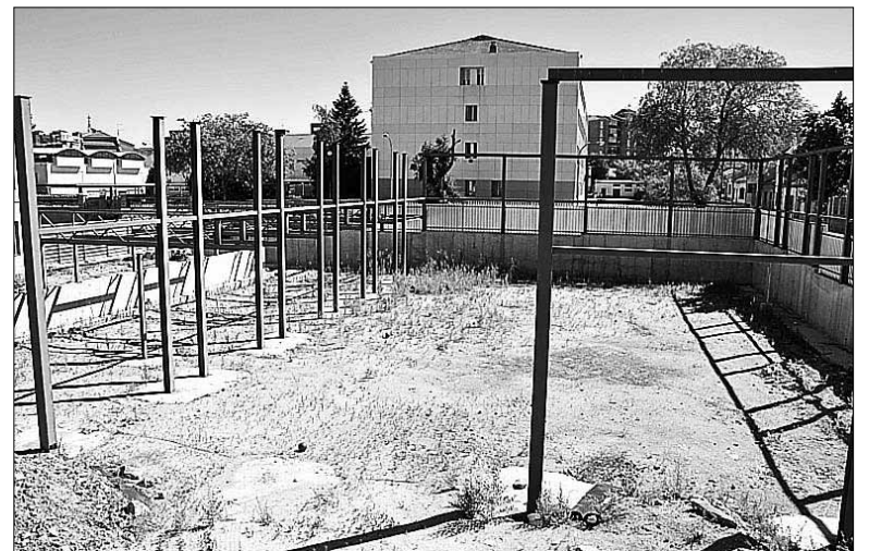
La obra fue paralizada en marzo de 2011, inutilizando parte del patio. / JUAN MARTIN
