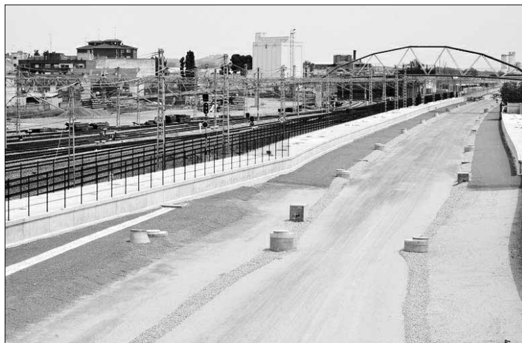
Obras de la alta velocidad en la estación de trenes de Venta de Baños. / ICAL
