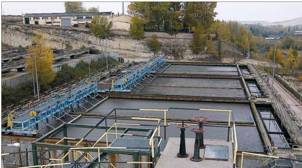
Imagen de archivo de la EDAR de Segovia, cuyas obras de ampliación se han licitado ya. / JUAN MARTÍN
