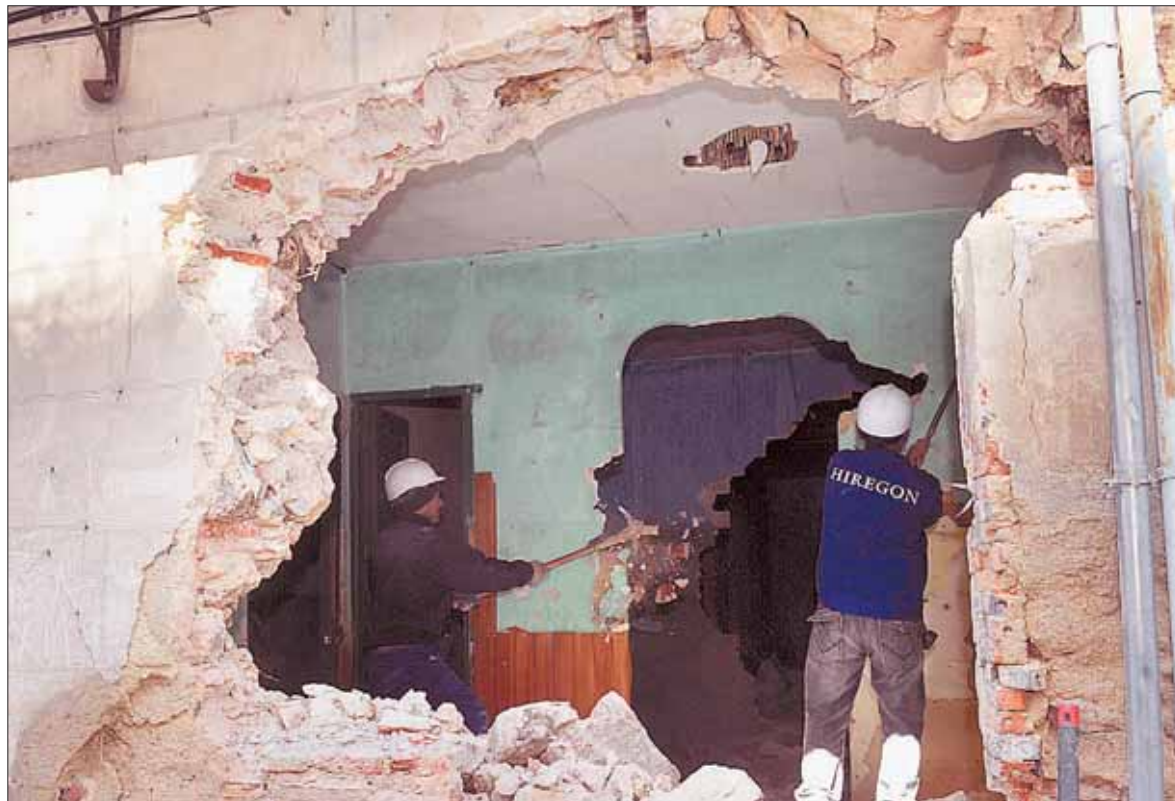
Los primeros trabajos de derribo se iniciaron en la mañana de ayer por un grupo de operarios de una constructora. /KAMARERO
