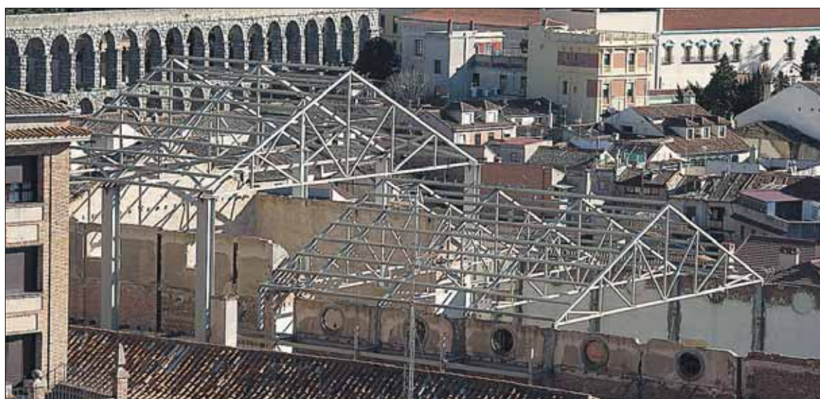
Las cerchas metálicas se corresponden con el proyecto que paralizó la Junta en 2006 por exceso de altura y volumen./A.K.
