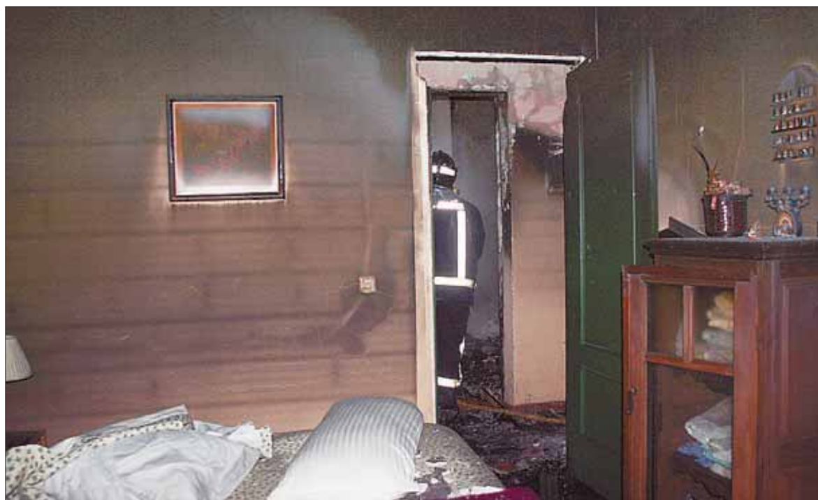
Imagen del interior de la vivienda que sufrió un incendio la semana pasada y que fue una de las últimas robadas. / F. D.
