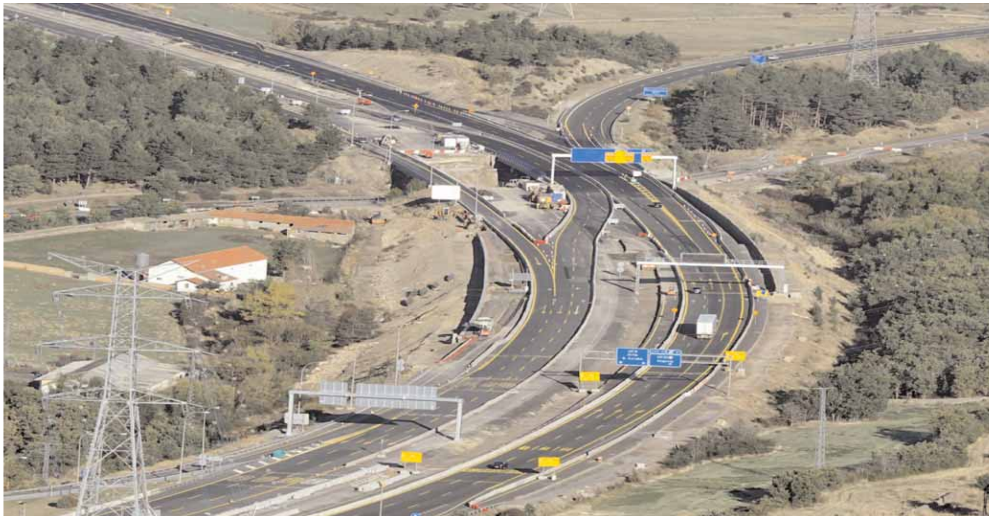
Imagen de la intersección entre la autopista AP-6 con la carretera N-603, donde todavía se están realizando trabajos de mejora por parte de Abertis Autopistas. / PEDRO L. MERINO
