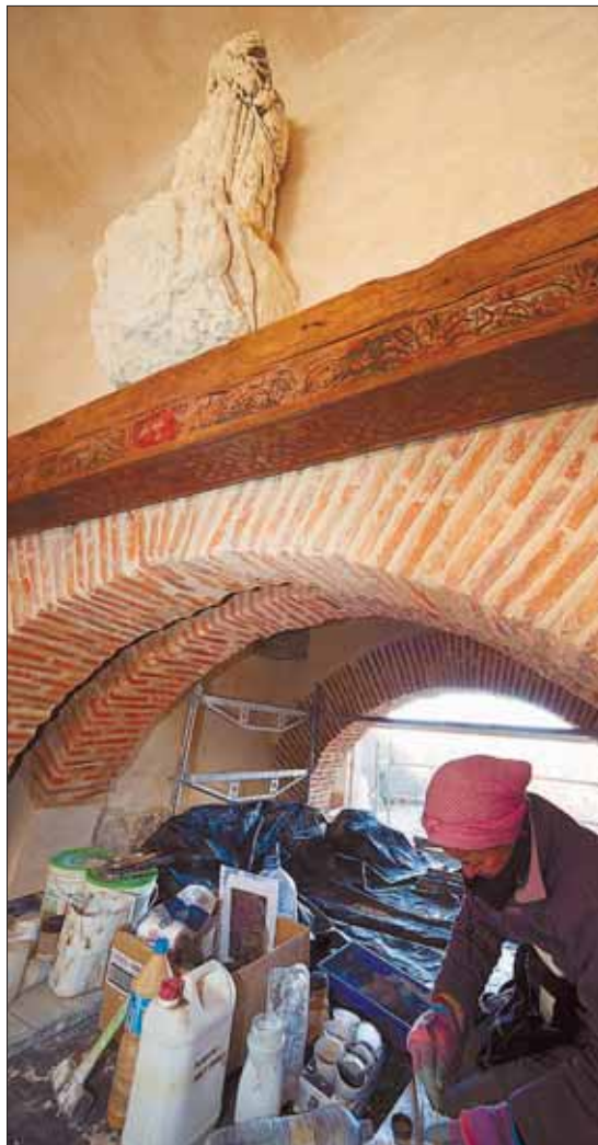
Una restauradora trabaja en la zona, en el interior de la Puerta, donde se encuentra la Virgen del Camino apoyada en unas vigas policromadas. / KAMARERO
