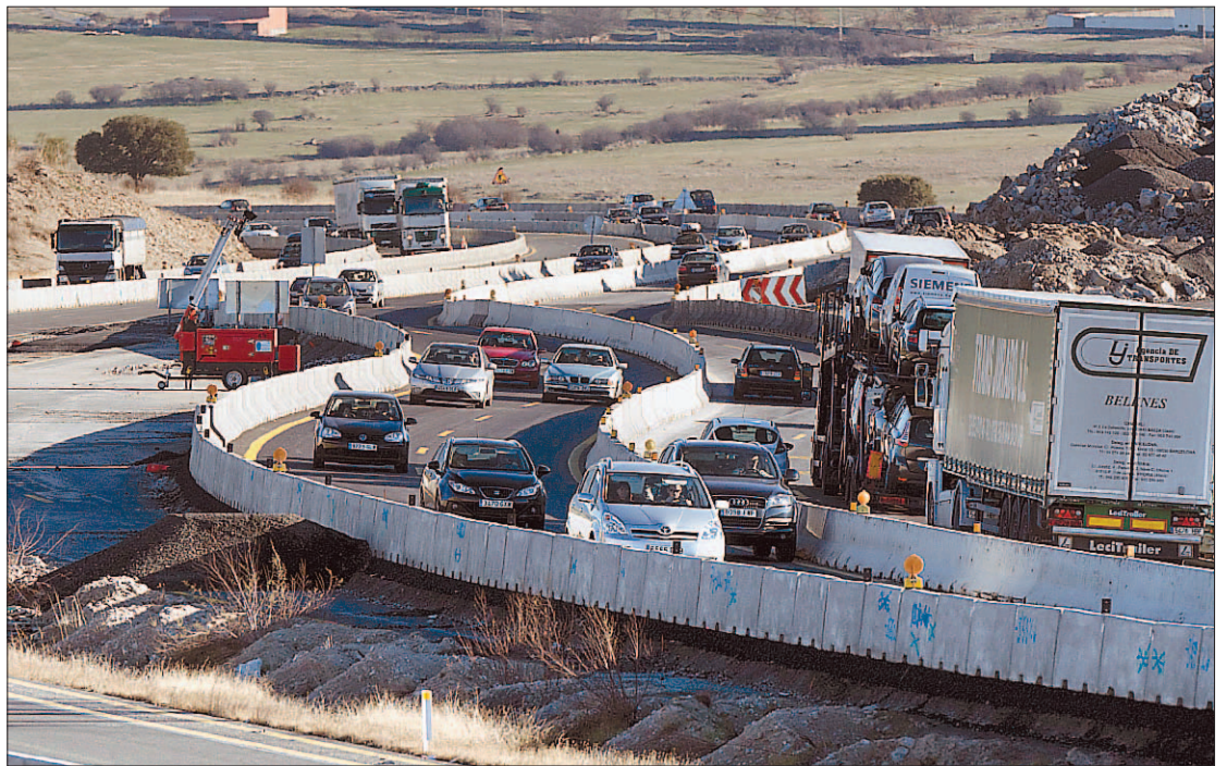
Las obras han estado paralizadas durante el periodo navideño y ayer se retomaron de nuevo para cumplir los plazos. / P.L.M.
