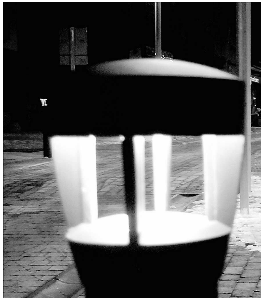
Nuevas farolas de bajo consumo instaladas en la avenida José Zorrilla de Segovia tras su remodelación.
