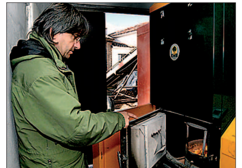
El alcalde, junto a una de las calderas. / A.B.
