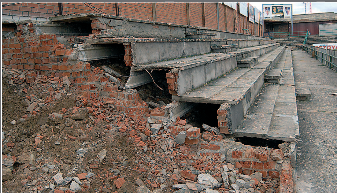
La grada de preferencia del campo de La Albuera, hueca por dentro. // JUAN MARTÍN
