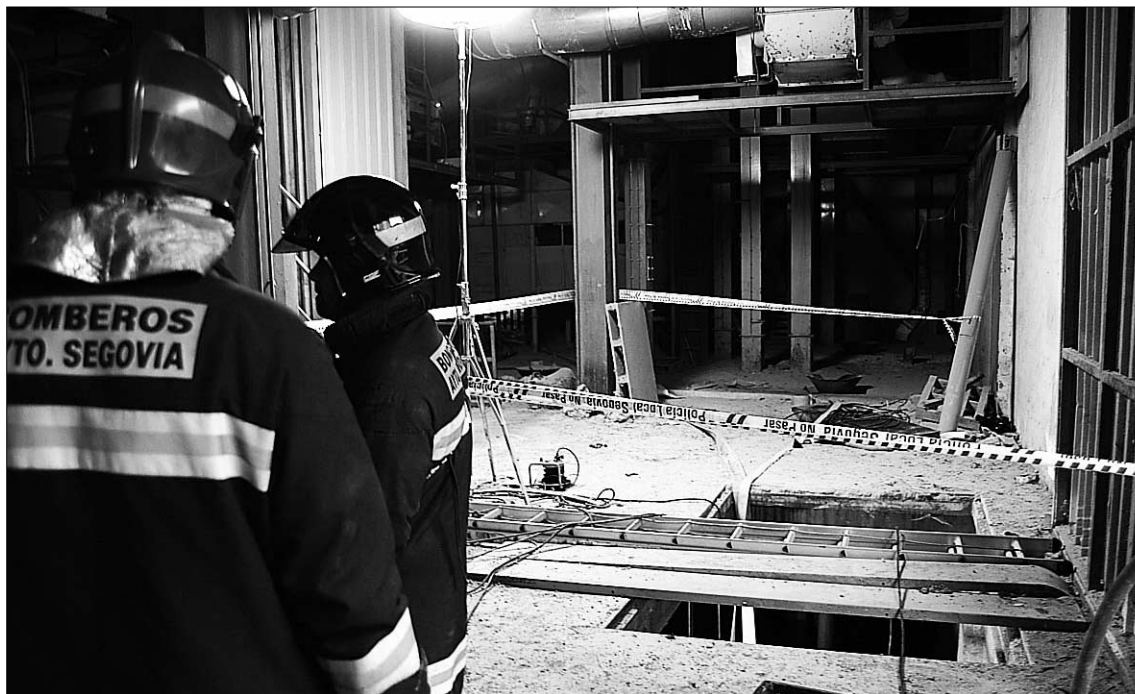
Los bomberos, en plena tarea de achique de agua desde el vano por el que cayó la víctima./KAMARERO
