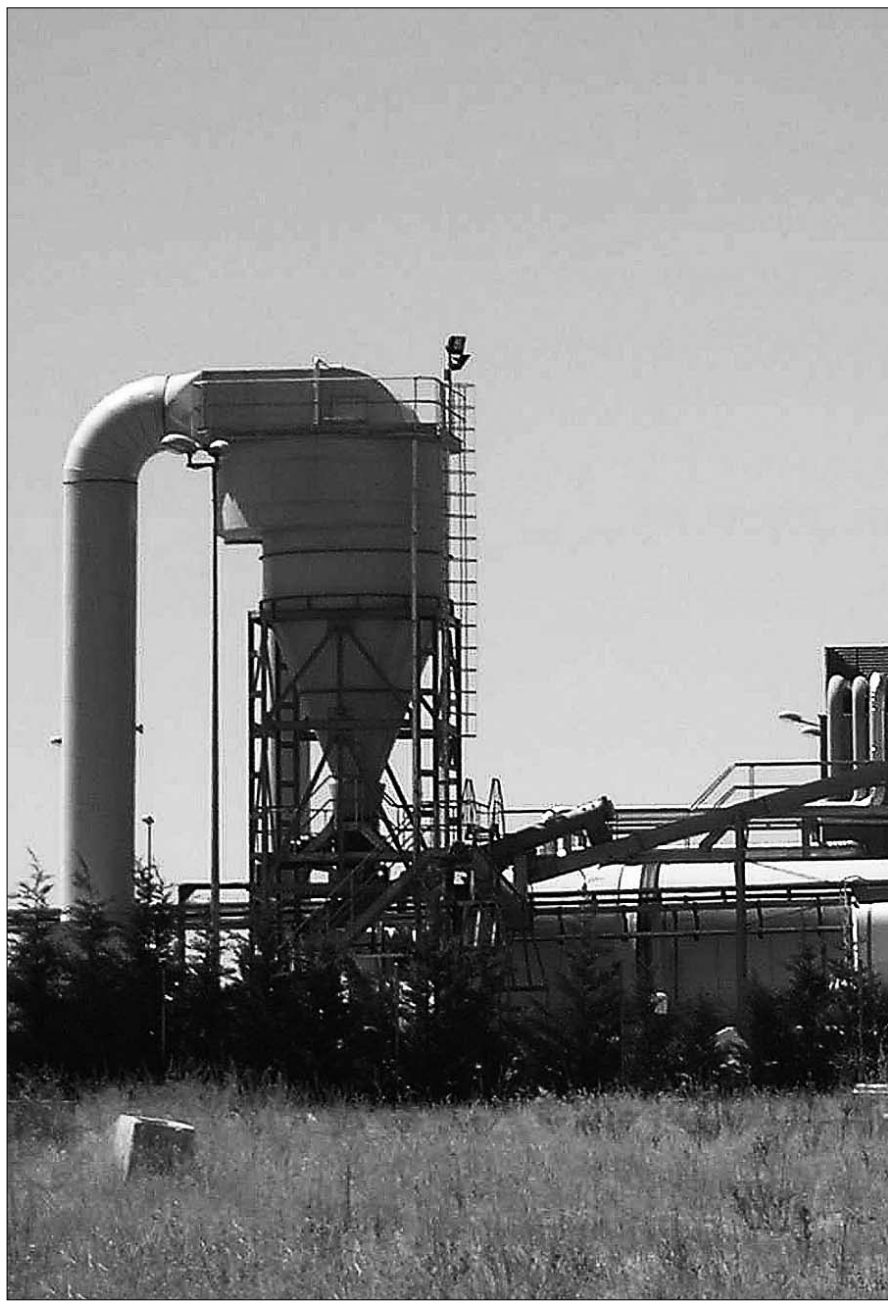
Imagen de la planta de tratamiento de purines de Turégano, la única existente en la provincia, y
