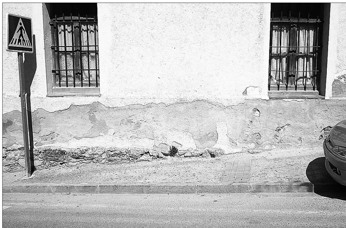
El estado de calles e instalaciones de Hontoria ha sido denunciado en varias ocasiones por sus vecinos./ EL ADELANTADO
