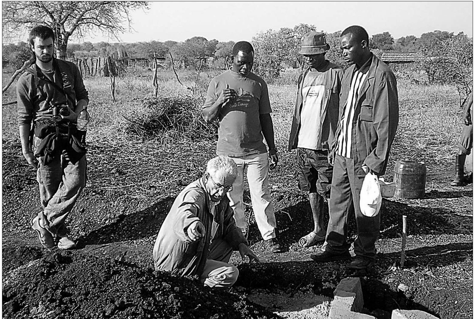
El director técnico, maestro de obras y peón albañil Jesús Torres, replantea los cimientos de uno de los consultorios.
