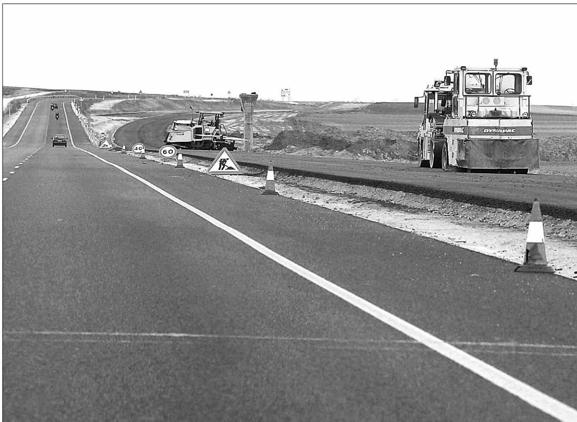
Obras de la futura autovía Segovia-Valladolid, licitadas por la Junta de Castilla y León. / JUAN MARTÍN
