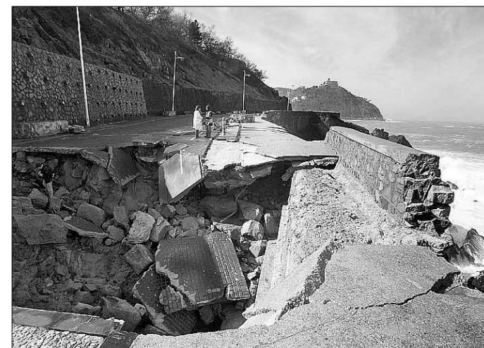
Los desperfectos por el tiempo han afectado a toda la zona norte. / EFE
